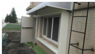
頂樓樓梯間 自動換氣百頁窗
