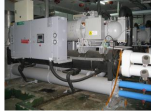
圖書館大樓高效率環保 冷媒R-134A螺旋滿液式 冰水機組120RT
