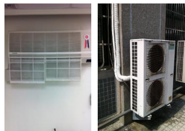
分離式冷氣空調機設備
